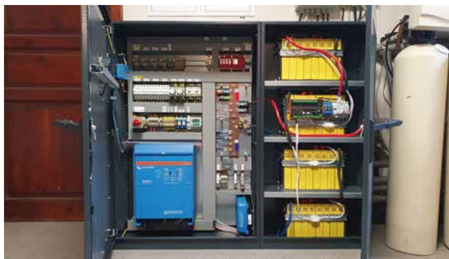
Obrázek č. 11: Kompletní FV elektrárna, záložní systém a bateriové úložiště z prismatických LFP článků pro domácnost
