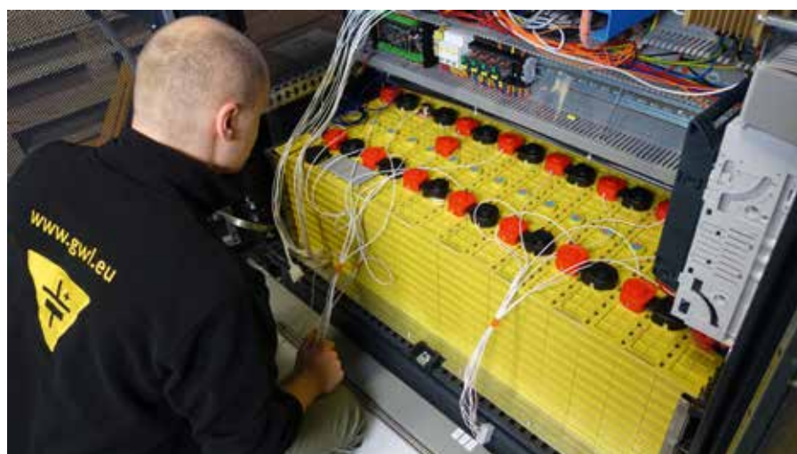
Obrázek č. 10: Takto může probíhat pohodlná údržba a servis bateriového úložiště z prismatických článků.
