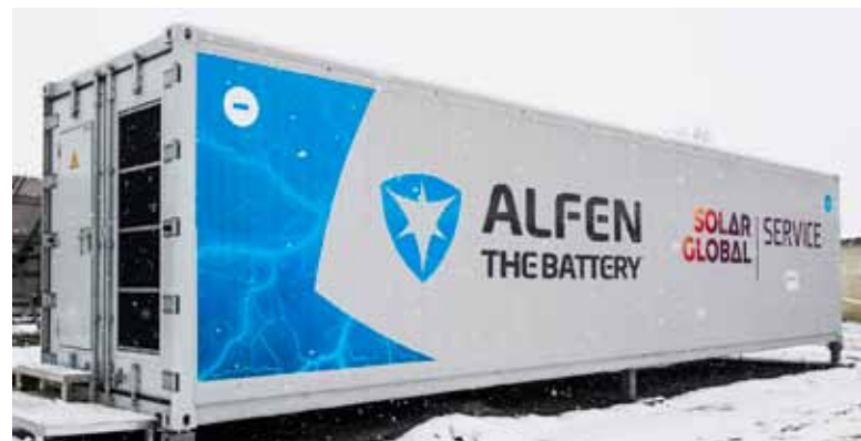
Úložiště ve slovácké obci Prakšice má kapacitu 1MWh a maximální výkon zhruba 1 MW. Jeho základem jsou lithium-iontové akumulátory, jak je dnes běžné
