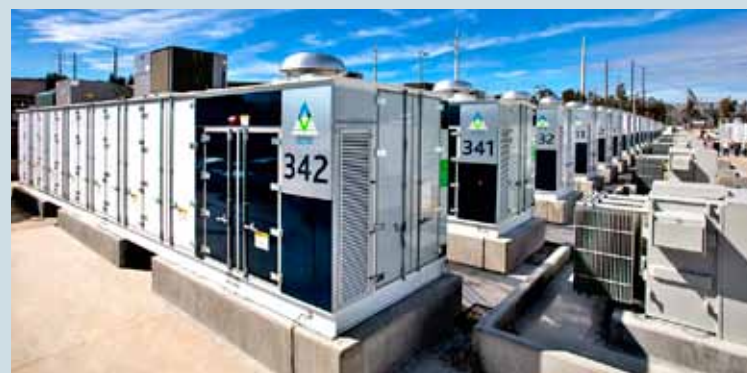
Bateriové úložiště s bateriemi Siemens
