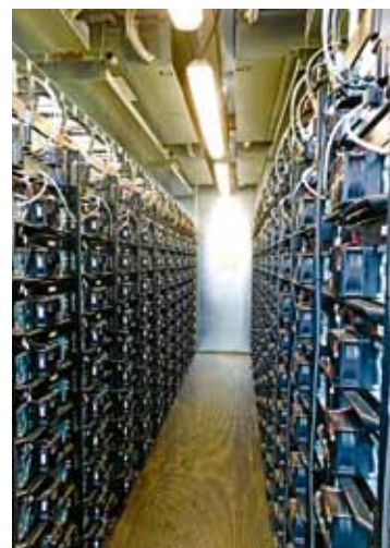
Vlastní akumulací část je tvořena velkým počtem Li-iontových baterií
